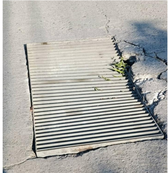
照片說明：萬山里中央路 (地固基)水溝蓋損壞
