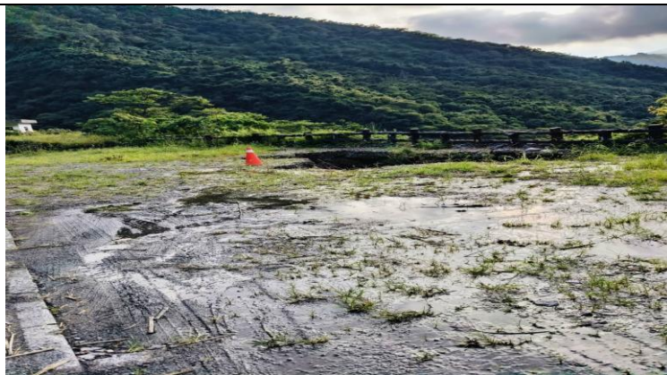
萬山美雅谷停車場損壞全景
