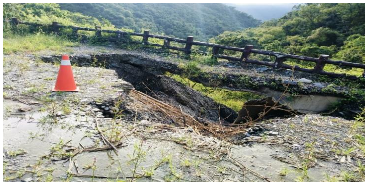
萬山美雅谷停車場擋土牆凹洞下陷
