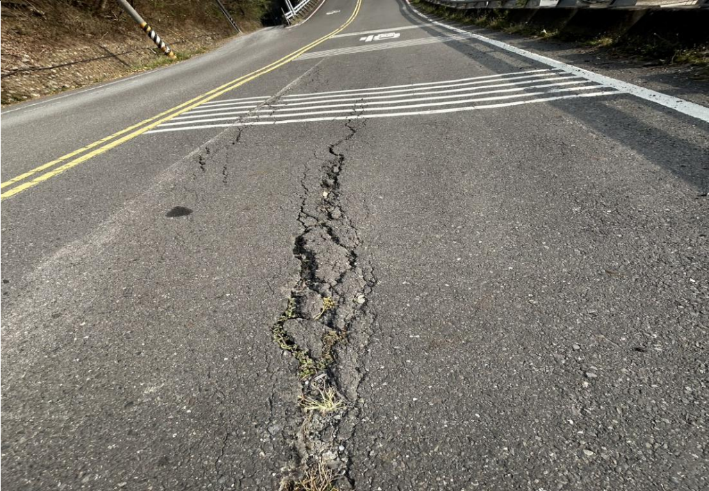
改善 132 線多納大橋頭路面損壞下陷案。
