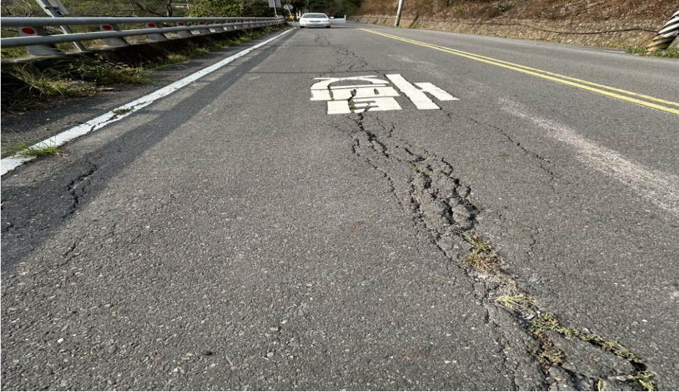
改善 132 線多納大橋頭路面損壞下陷案。
