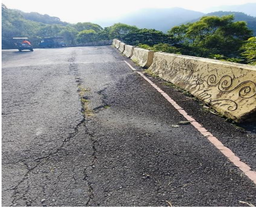
照片說明：排水系統不良形成路基下陷。
