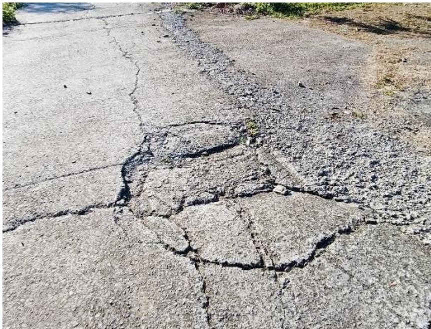
照片說明：路面龜裂潛在風險
